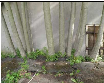
Dégât envers le trottoir et un bâtiment à Nanterre-Triage, causé par l'ailante (Photo B. Lisan).
